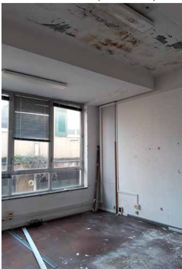
Dettaglio del degrado causato dalle infiltrazioni nei locali posti a est
